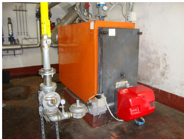
Figura 4.11 - Particolare di caldaia a gas metano
