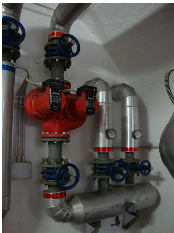
Figura 4.7 - Particolare della pompa gemellare e termostati fluidi di mandata
